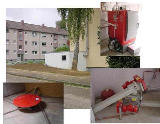
Hackschnitzellager mit Heiz- und Fördertechnik
